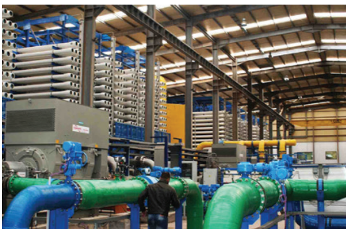
Usine de dessalement
